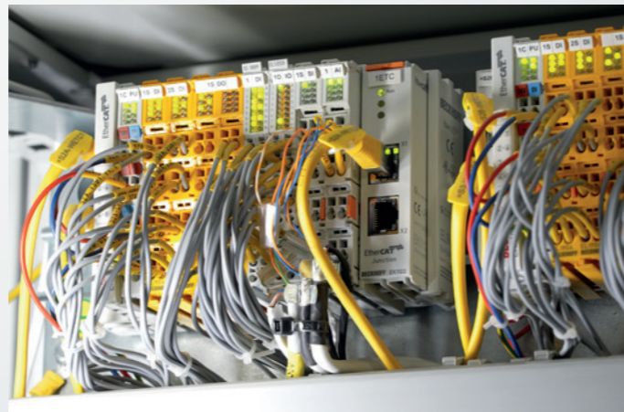
Vezérlőszekrényben elhelyezett EtherCAT-es I/O-szigetek: digitális ki-bemenetek, safety I/O-modulok és EtherCAT hálózati elosztók
