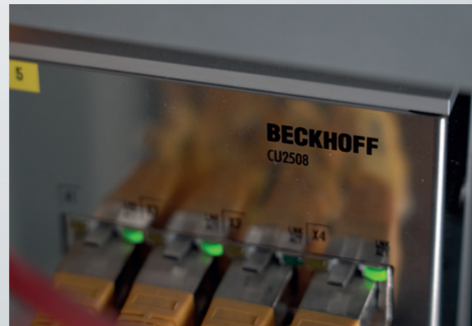
Szerverszekrényben elhelyezett Beckhoff CU2508 Ethernet port-elosztó, ami egyszerre 8 Ethernet hálózat csatlakozását teszi lehetővé
