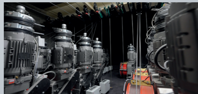
Hangszigetelt gépházban elhelyezett ponthúzó gépcsoportok
