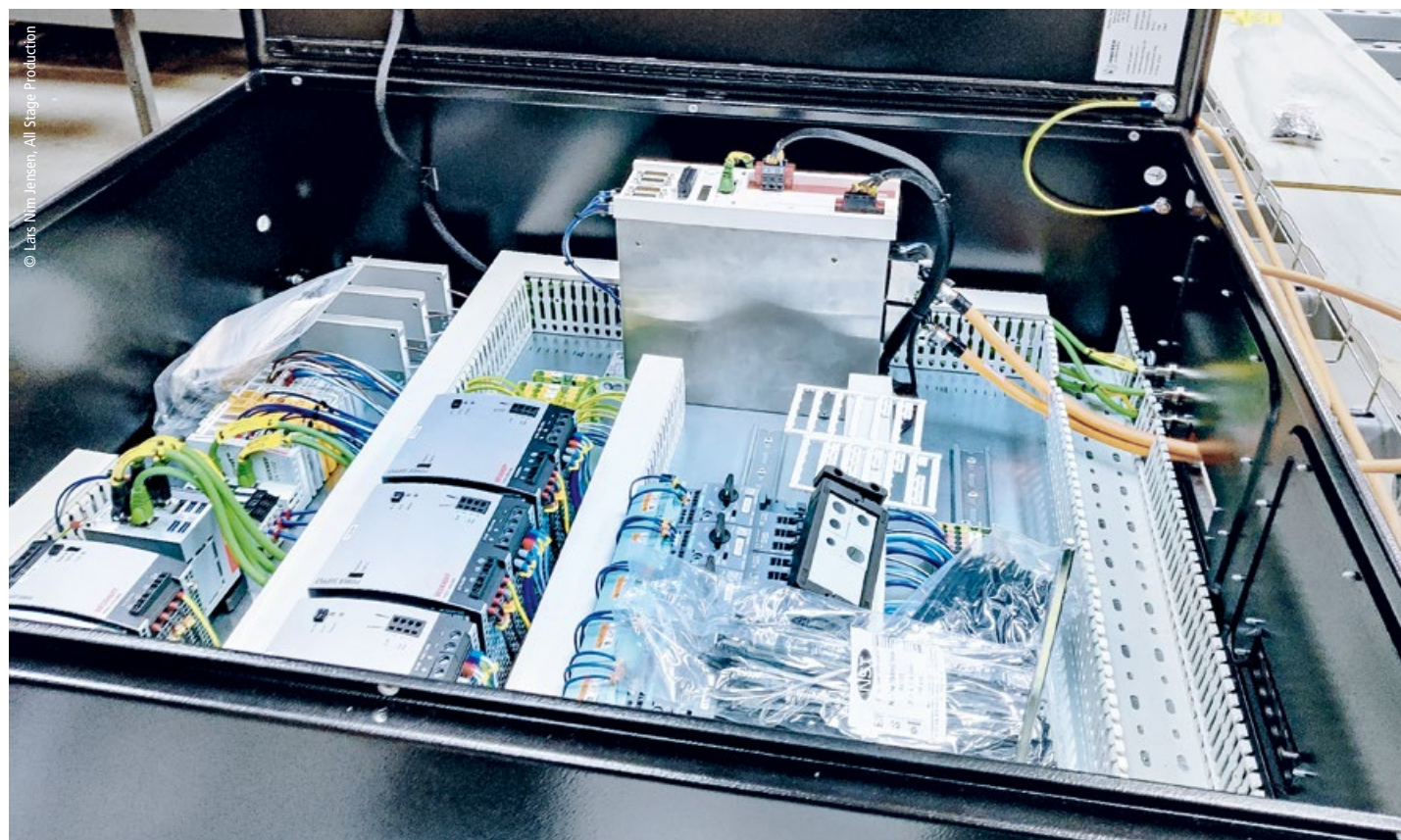
Schaltschrank während der Montage mit einem zweikanaligen Servoverstärker AX52xx, einem Ultra-Kompakt-Industrie-PC C6017 und mehreren Netzteilen PS3000 für die Stromversorgung der dezentralen Servoantriebe AMI8100
