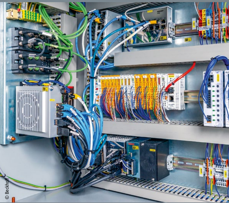
Ein Blick in den Schaltschrank verdeutlicht das breite Spektrum der eingesetzten Beckhoff Komponenten – vom Ultra-Kompakt-Industrie-PC C6032 über die CP-Link-4-Senderbox CU8803 und die batteriegestützte USV CU8130-0240 bis hin zu EtherCAT-Box-Modulen sowie EtherCAT- und TwinSAFE-Klemmen.
