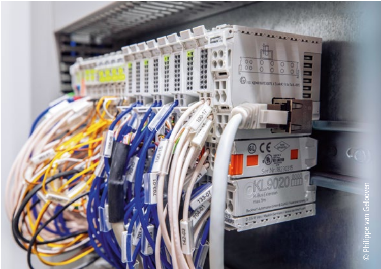
Mehrere Dutzend Embedded-PCs CX5230 und über 120 TCP/IP-Koppler BK9050 erfassen alle Informationen der Subsysteme für HVAC, Sanitär, Elektrik, Beleuchtung, Beschattung und Brandschutz.
