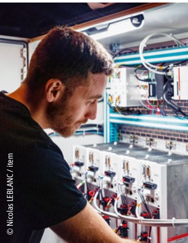
Durch Schulungsmaßnahmen vor Ort können die Techniker der Opéra Bastille auftretende Fehler selbstständig und schnell beheben.
