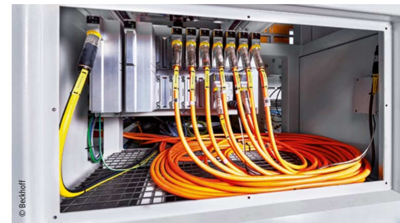
Das MX-System im unteren Teil der Maschine sorgt unter anderem für einen reibungslosen Transport der mit Pulverlack gefüllten Kartons durch die Anlage.
